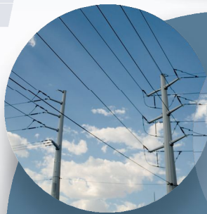
Оборудование, обеспечивающее передачу электроэнергии от места генерации по распределительным сетям
